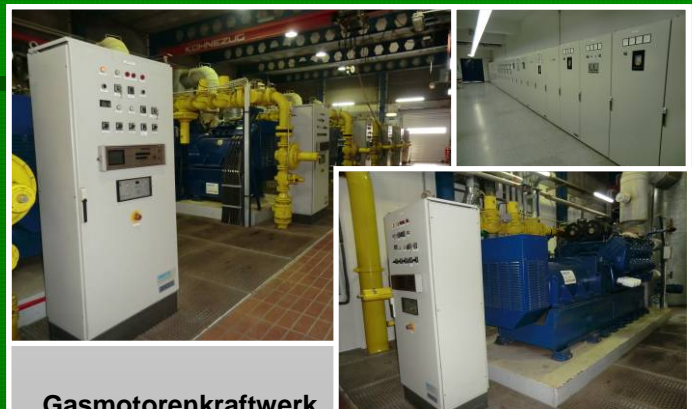
Gasmotorenkraftwerk Abfallwirtschaftszentrum Mechernich-Strempt
